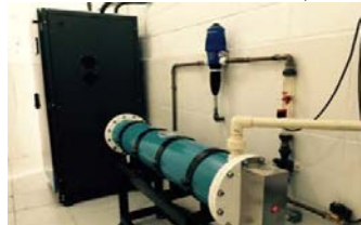
e) Gerador de 100 kg/h
