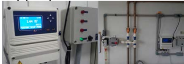
f) Analisadores do gerador cloro - 100 kg/d
